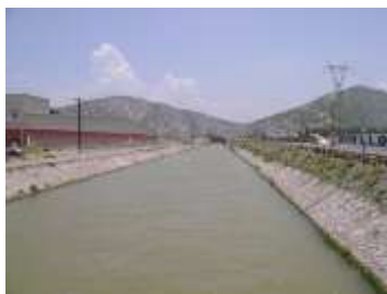
Imagen 56. Estado actual del canal Sacramento.
